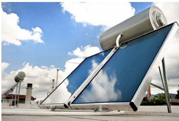
4. Kép Tetőre telepített napkollektoros fűtőrendszer (forrás, Antonis Liokouras/Getty Images)
