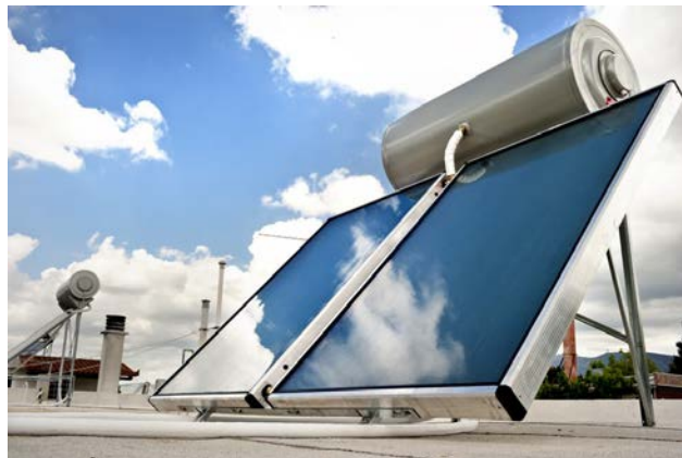
Zdjęcie 4 System dachowego ogrzewania energią słoneczną (źródło: Antonis Liokouras/Getty Images)
